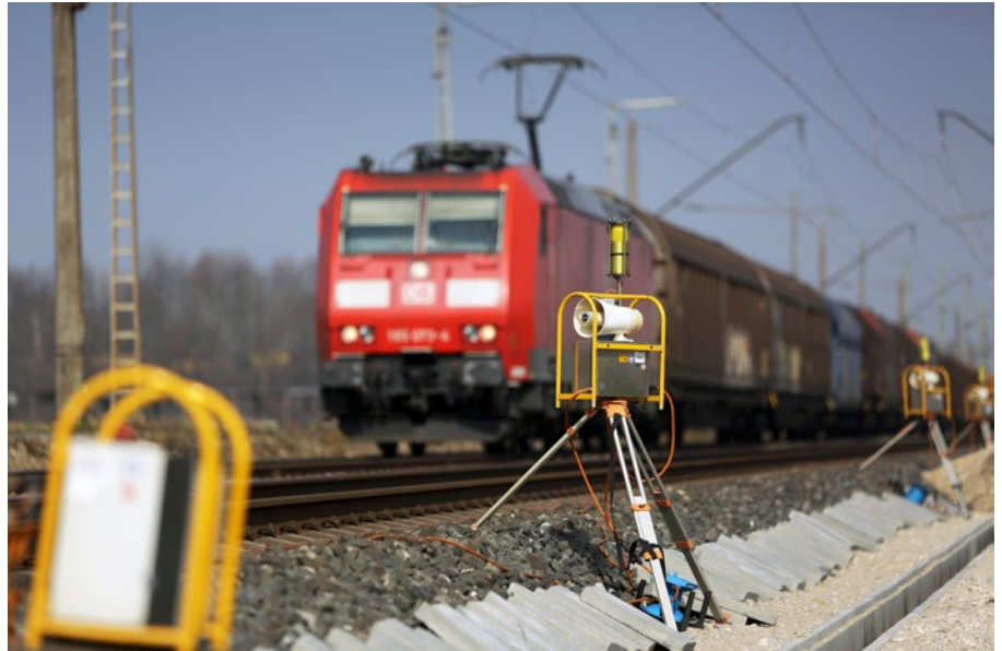
2: Arbeiten am Oberbau haben einen prozentual starken Einfluss auf die Zahl baubedingter Betriebserschwerisse Quelle: DB AG / Martin Busbach
